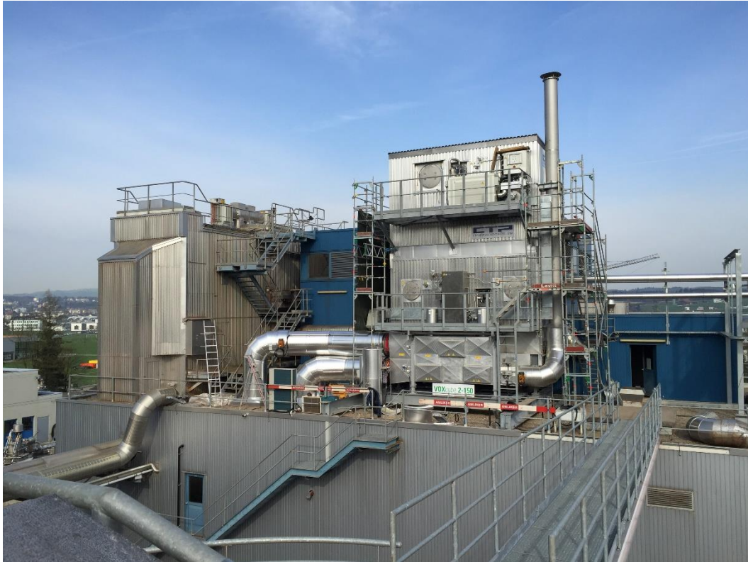
Regenerative Thermische Oxidation zur Reduktion des klimarelevanten Lachgases aus den Rauchgasen der Schlammverbrennung
