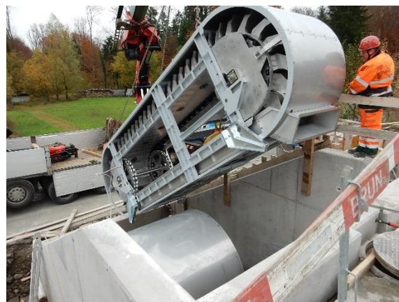
Abwasserturbinen am Ablauf der ARA
