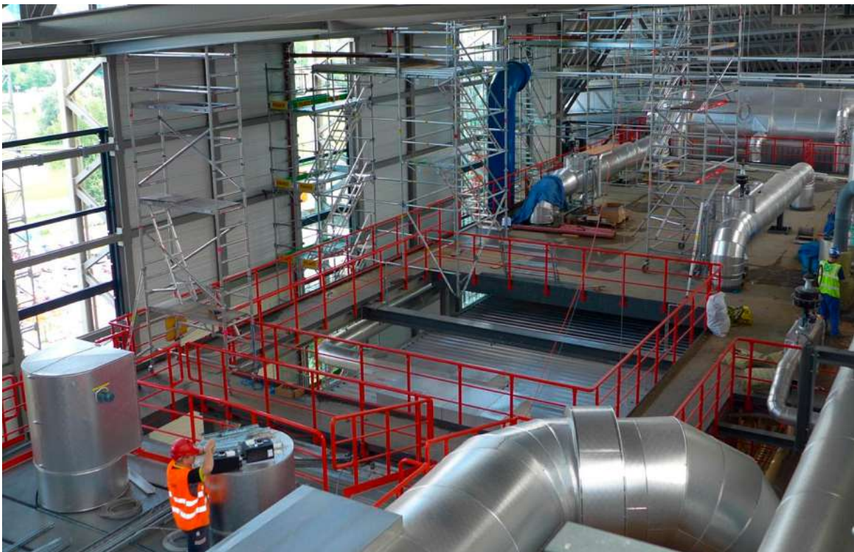
Renergia: Sicht ins Kesselhaus.
