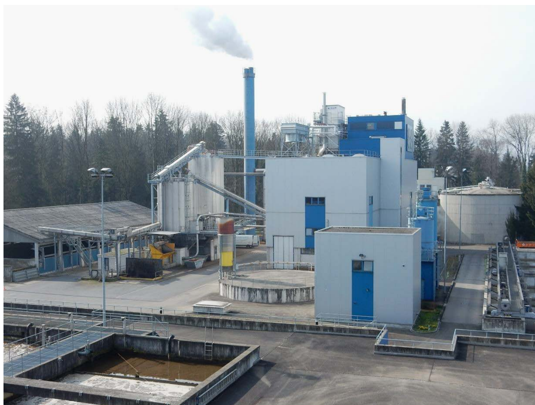
Blick auf die Schlammverbrennungsanlage
