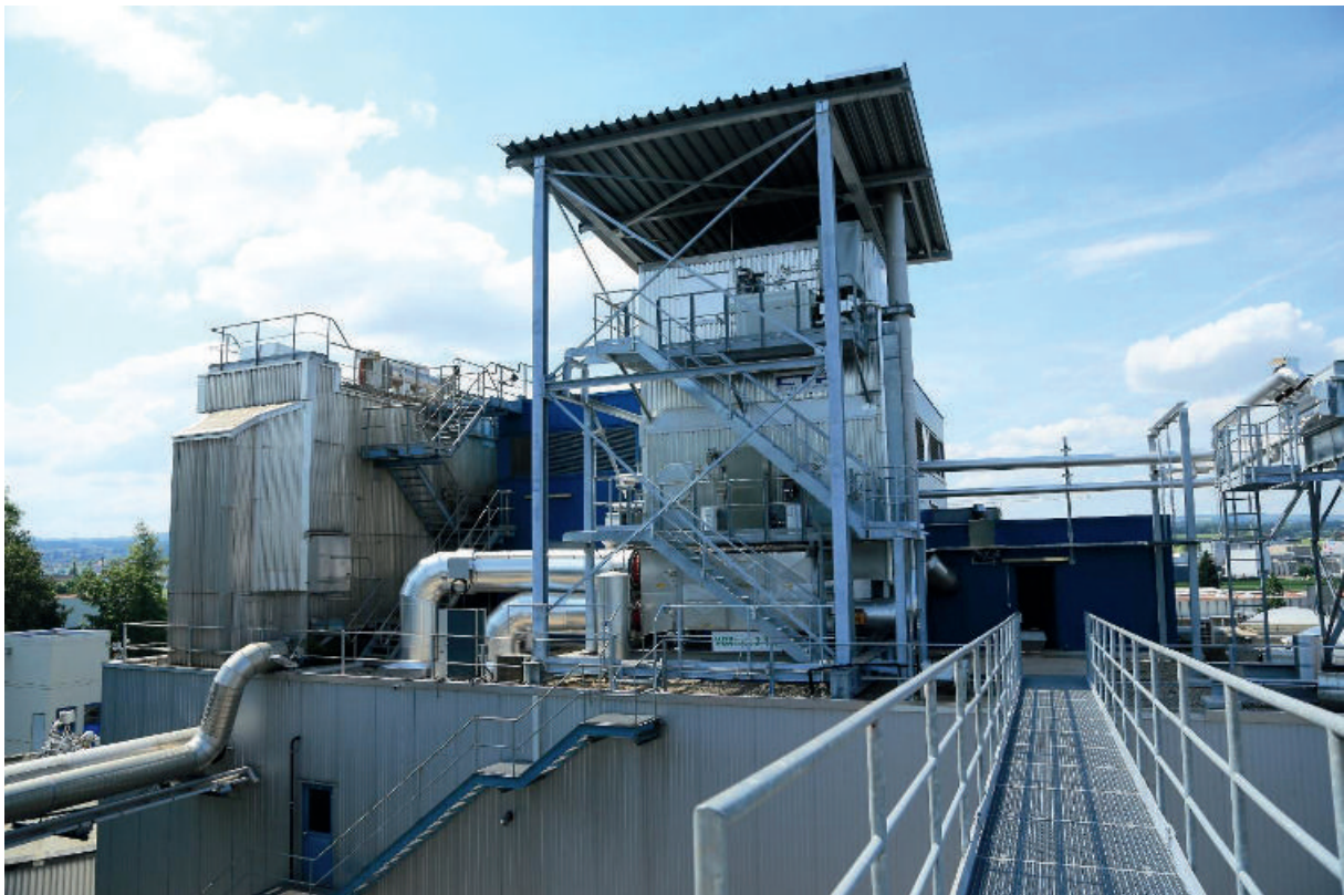
RTO-Anlage auf dem Dach der SVA aus der Nähe betrachtet. Rechts ist teilweise der neue Luftkondensator sichtbar.
