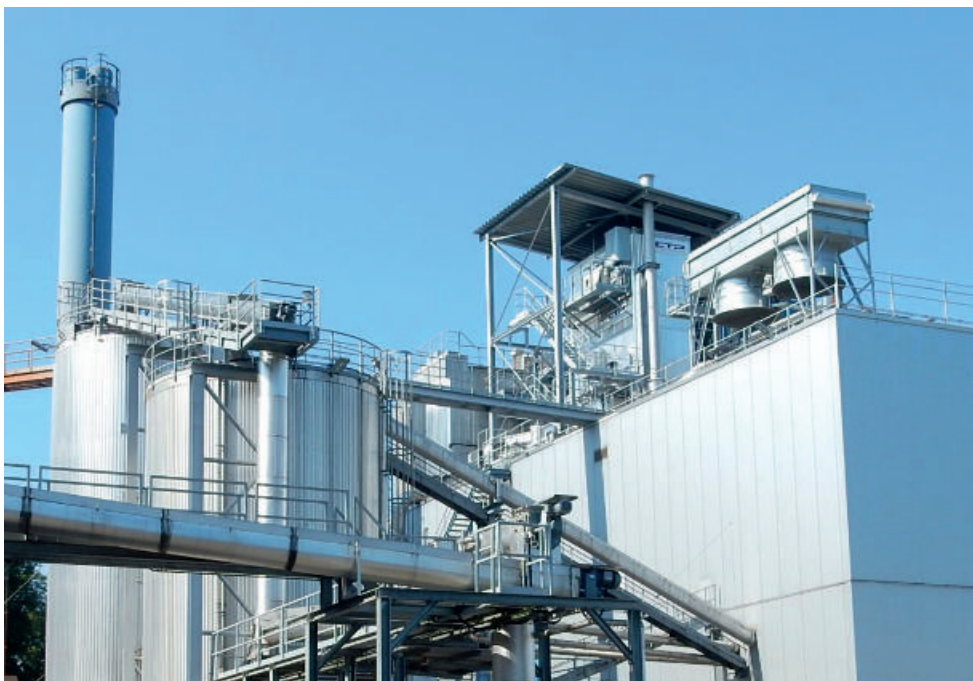
RTO-Anlage rechts auf dem Dach der SVA
