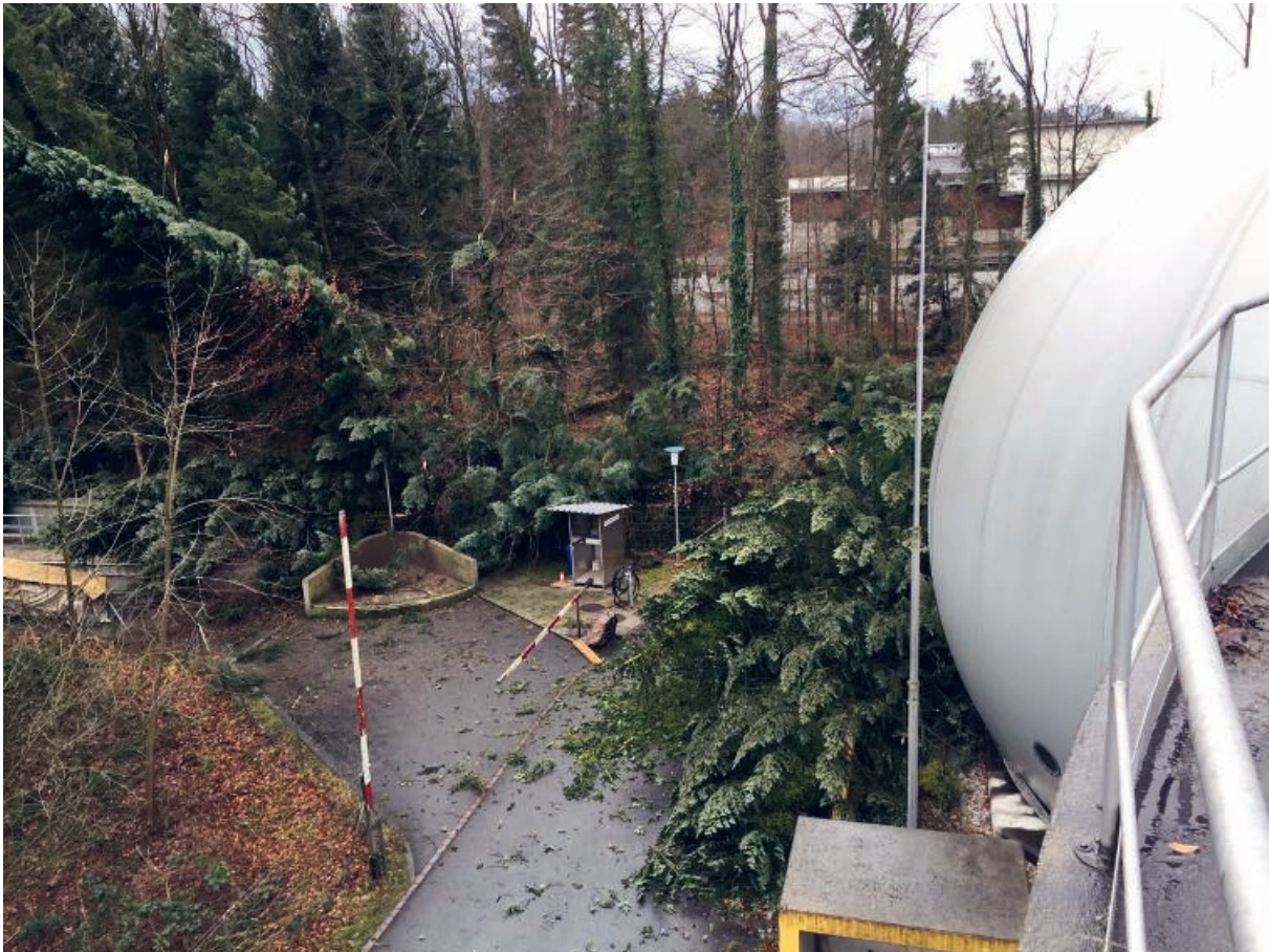
Sturmschaden bei der ARA Buholz zwischen Gasspeicher und Notentlastung
