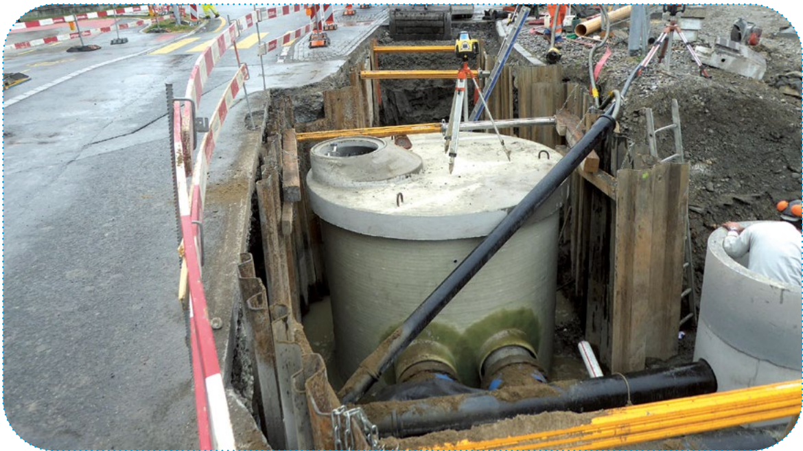
Ein Revisionschacht an der Allmendstrasse in Horw, in den die beiden neuen Druckleitungen münden.
