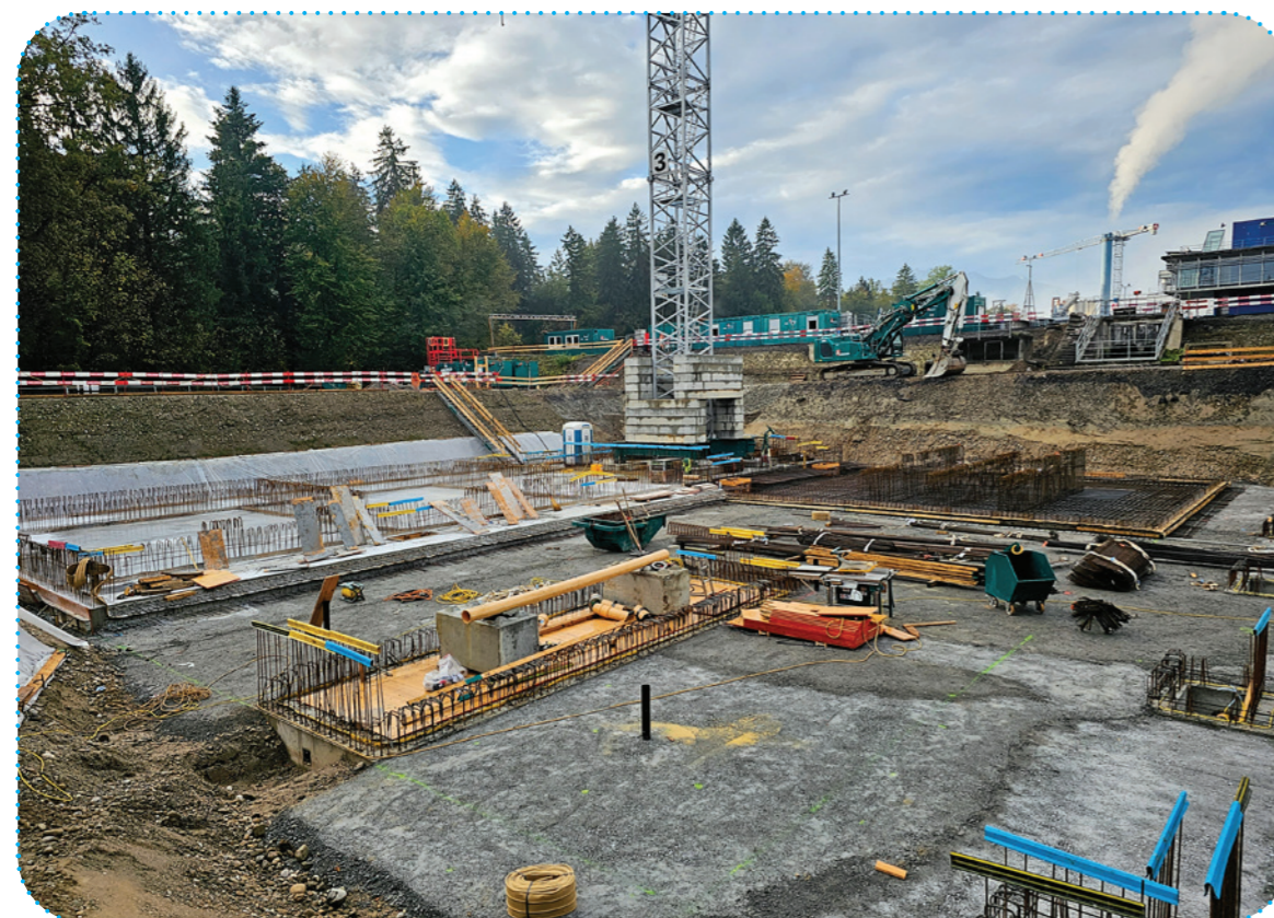
Dank des sehr trockenen Herbstes konnten bis Ende 2023 bei der Anlage zur Elimination von Mikroverunreinigungen die ganze Bodenplatte betoniert und ein Grossteil der Reaktorwände erstellt werden.
